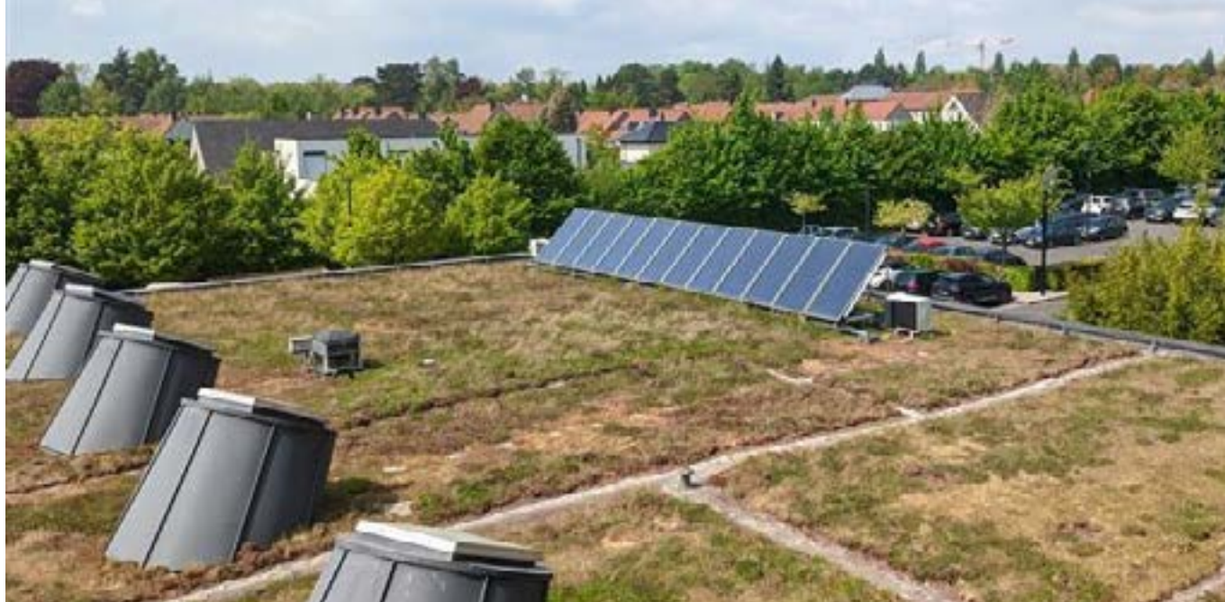
Panneaux solaires sur toit du siège social de Verspieren à Wasquehal (59)
