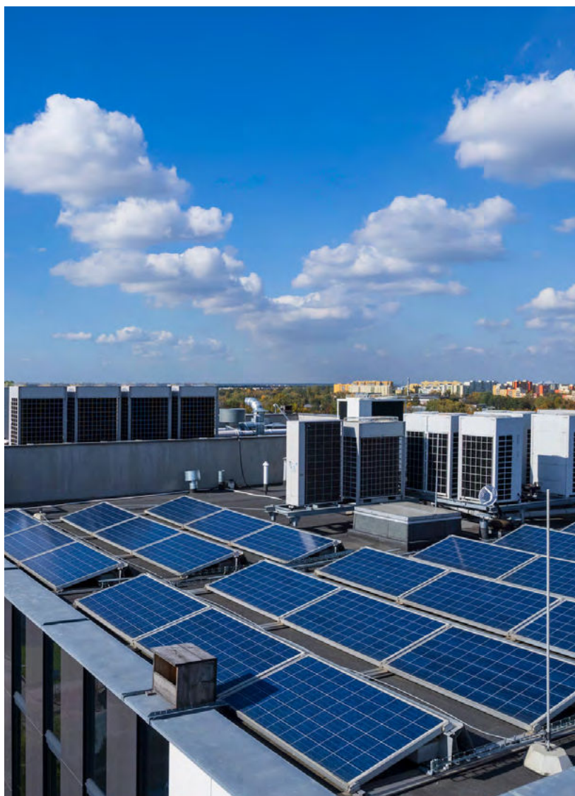
Des panneaux photovoltaïques installés sur un toit.
